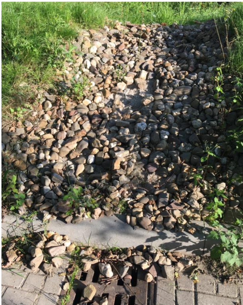
Figuur 3-19: Overstort van water lijkt te hebben geleid tot verspoeling van de keien in de overstort van de wadi van Hotel De Roskam. Foto: 23-8-2019
